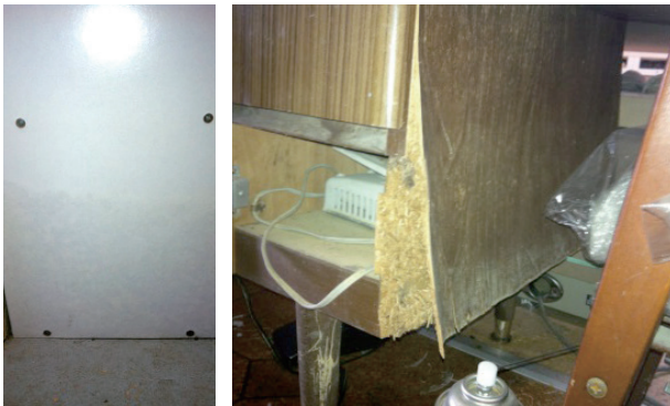
(a) 浸水ライン (市場内) (b) 浸水による貼り板損傷
